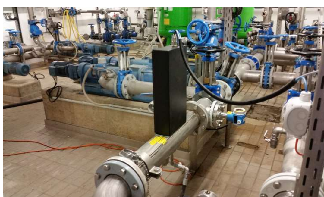
Messung bei Durchsatz ca. 12 m³/h
