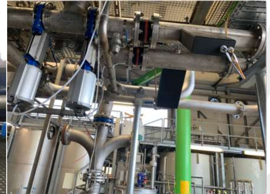
Messung bei Durchsatz bis 90 m³/h
