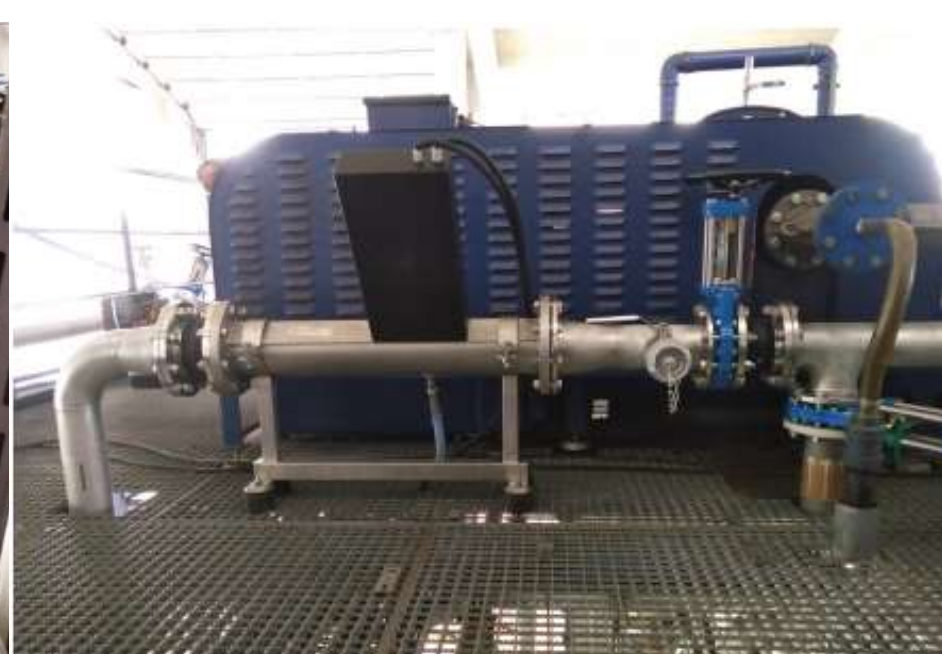
Messung bei Durchsatz bis 30 m³/h
